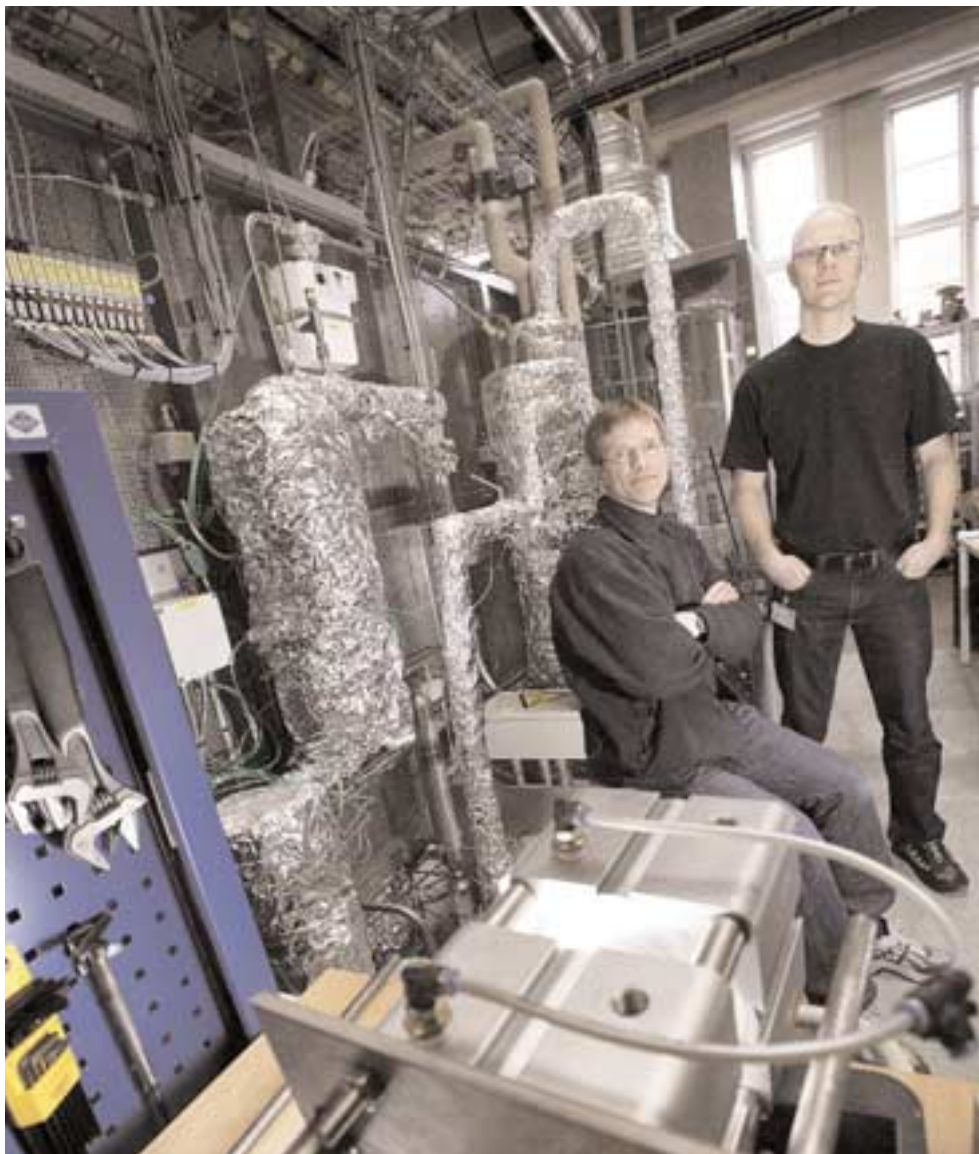
Teknom Cliver Klitholm og kemotekniker Anders Kjærskov arbejder begge med udviklingen af SOFC-brændselsceller i Topsoe Fuel Cells. Her står de foran et pilotanlæg med en effekt på ca. 5 kW el. Foto: Joachim Rode.
